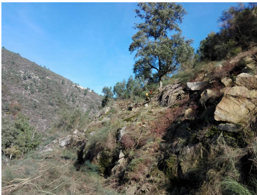
SET | Desmatção na encosta da margem esquerda do Rio Tâmega.
